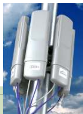
Cluster di 6 Access Point (AP) per 360° di apertura
